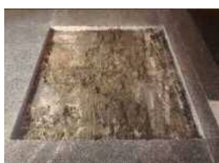
《コンクリート床版の損傷》
