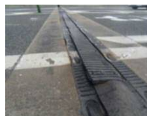
《伸縮継手の損傷》
